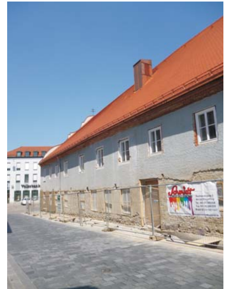
Auch äußerlich sind die Instandsetzungs- und Umbauarbeiten am alten Seethaler-Gebäude mittlerweile deutlich sichtbar
